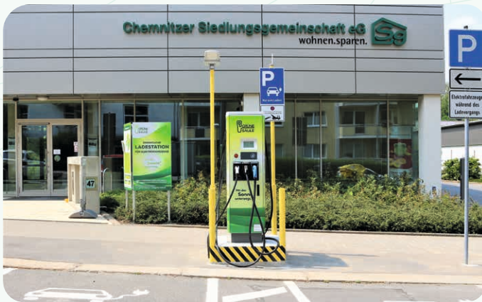
Schnellladesäule vor dem CSg-Geschäftsgebäude
