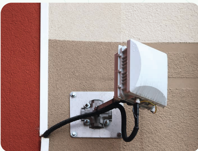
WLAN-Hotspot im CSg-Bestand
